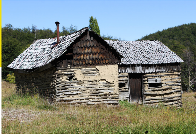
Figura 3. Arquitectura vernácula construida con la técnica de la quincha, poblador Adrián Delgado (Q.E.P.D.), sector Mallín Grande, comuna de Chile Chico. Está abandonada desde hace un par de años y se encuentra con varios problemas de deterioro de sus materiales originales. Fotografía: Carlos Castillo Levicoy 2021
